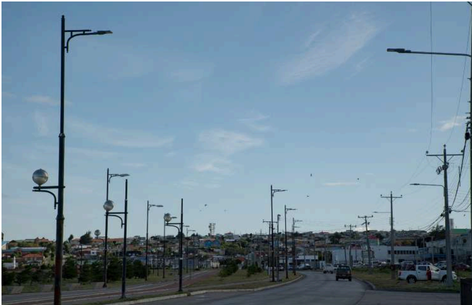
EN PORVENIR, LAS NUEVAS LUMINARIAS RECIÉN INAUGURADAS BRINDAN UNA SIGNIFICATIVA MEJORÍA EN LA CALIDAD DE VIDA DE SUS HABITANTES.
